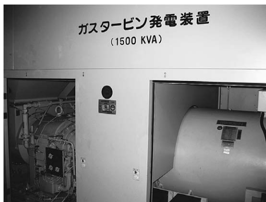
図 2 ガスタービン発電装置 1500KVA (中央棟)
