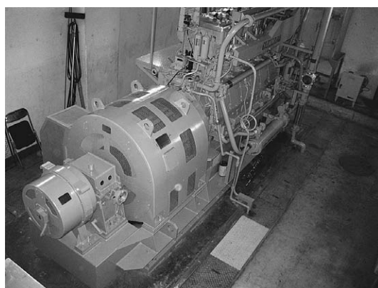
図 3 水冷式ディーゼル発電装置 1250KVA (入院棟)
